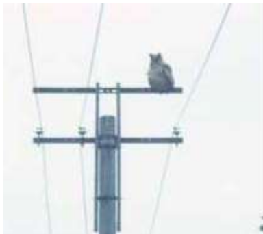
写真 感電防止策として配電柱に設置した止まり木 に止まるシマフクロウ
