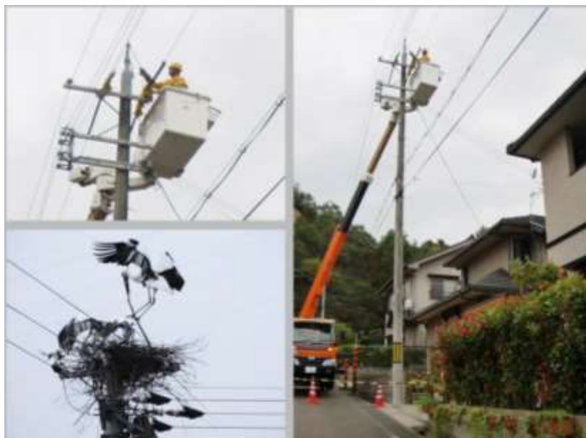
写真 営巣防止対策の作業風景と配電設備に営巣するコウノトリ (出典：関西電力 Facebook) ※豊岡では電力会社が対応作業を全て行っている。
